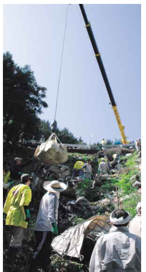
クレーンを使い、大量の不法投棄ごみの撤去作業を行う皆さん=眉山山中、4月
