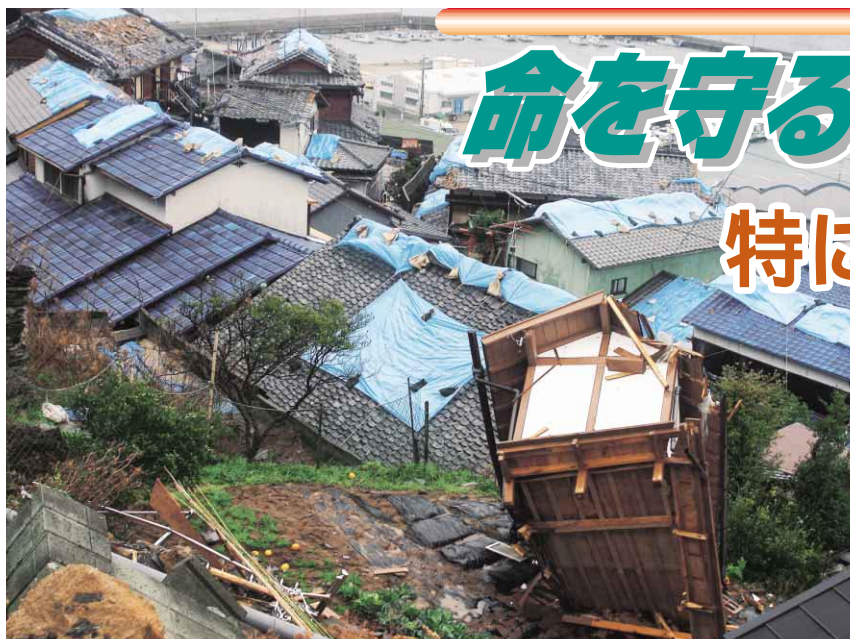
福岡県西方沖地震で多くの建物が倒壊するなどの被害を受けた玄界島く写真提供/福岡市
