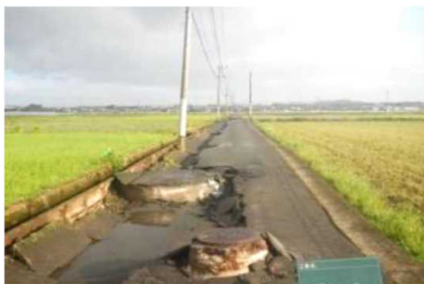
地震による管渠破損
