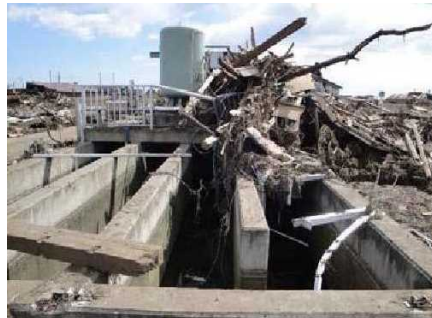
津波による排水施設被害
