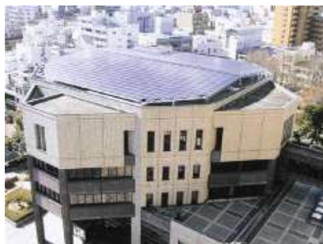
徳島市庁舎太陽光発電システム
