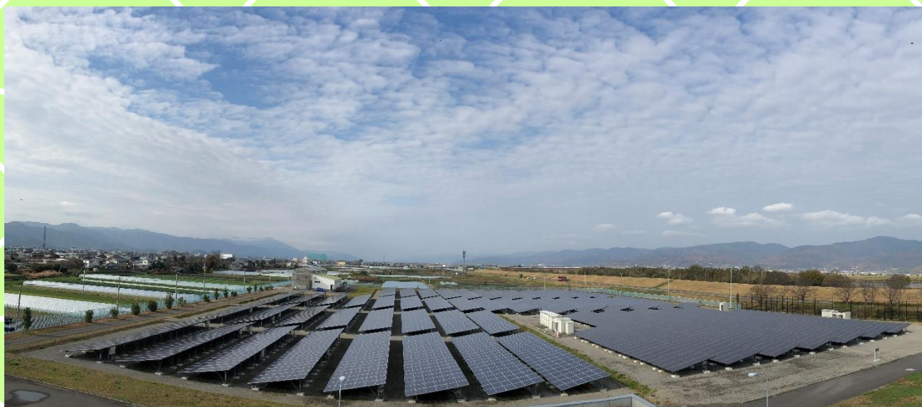
水道局第十浄水場 大規模太陽光発電設備
