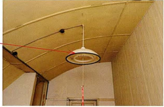
229 3階小供室（北）天井
