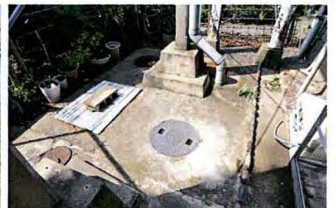
9. 浄化槽 主屋の南側に設置された浄化槽。
