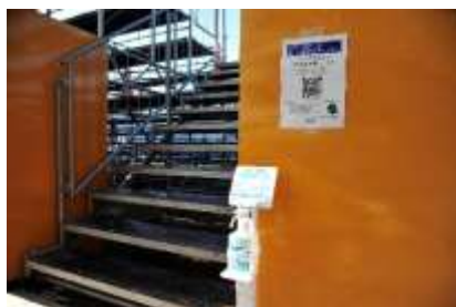
階段入口にアルコールスプレーを設置
